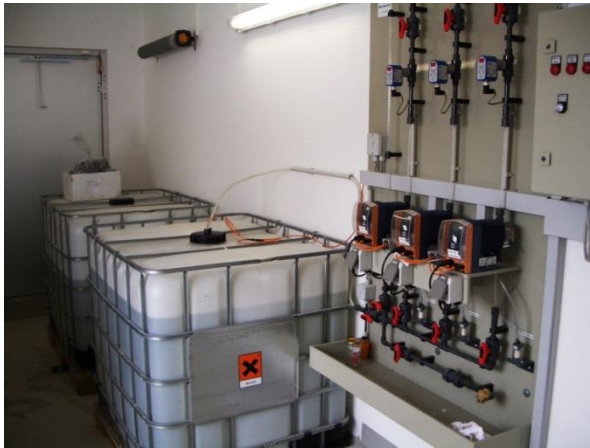
Beispiel einer Lager- und Dosierstation
